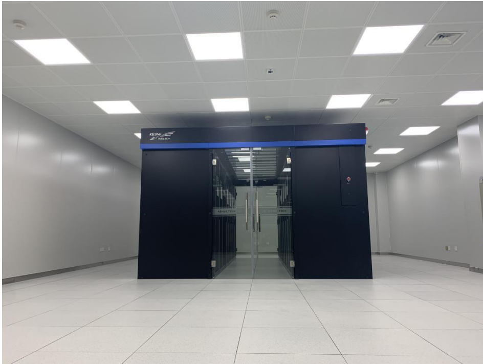
图4 高效、节能、可扩展的数据中心模块式冷通道机房
