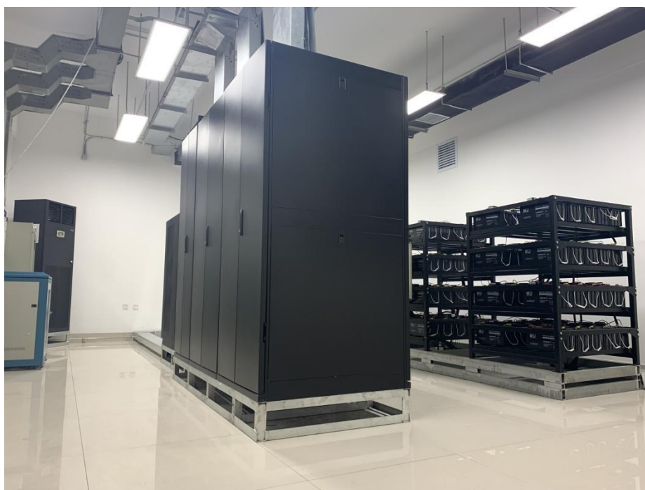
图3 A级标准建设的数据中心机房配电室
